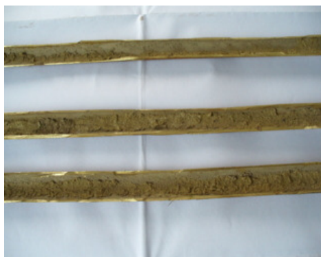
Fig. 1. Țevi de condensator cu depuneri la interior.
