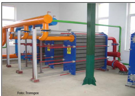
Fig. 2. Schimbătoare de căldură cu apă geotermală ale firmei TRANSGEX
