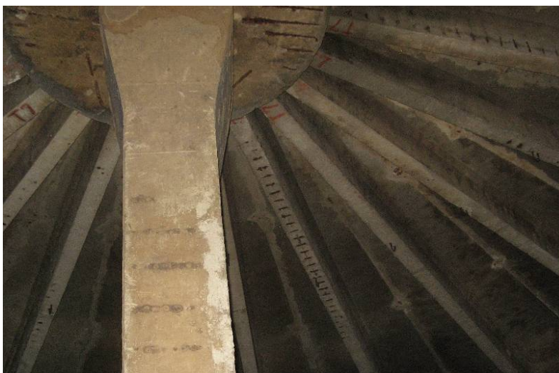
Fig. 3 – Ansamblu stâlp-capitel-acoperiș cu probleme de acoperire cu beton a armăturilor
