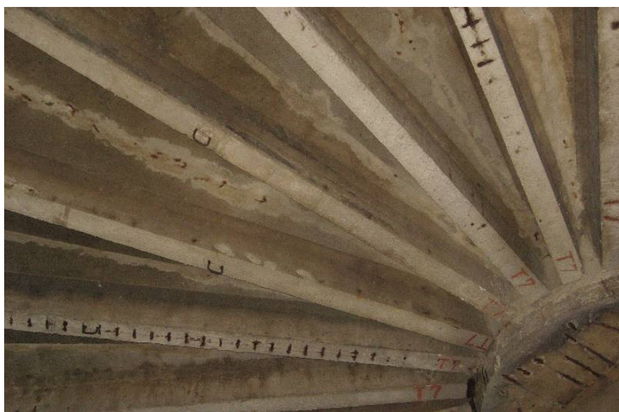
Fig. 2 – Element de acoperiș cu probleme în sensul acoperirii cu beton a armăturilor
