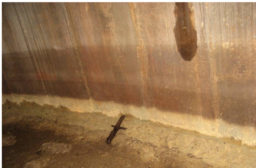
Fig. 4 – Pardoseală de fund deteriorată
