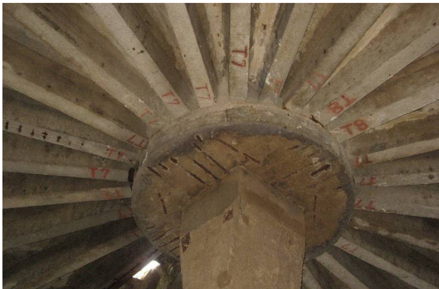
Fig. 1 – Aspect de deteriorare la nivelul acoperișului și grinzilor prefabricate tip „T”
