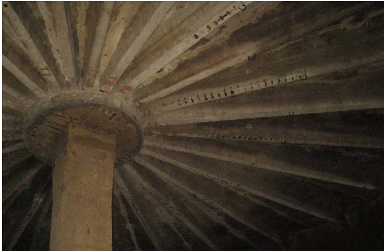
Fig. 6 – Capitel și stâlp central cu probleme de acoperire cu beton a armăturilor
