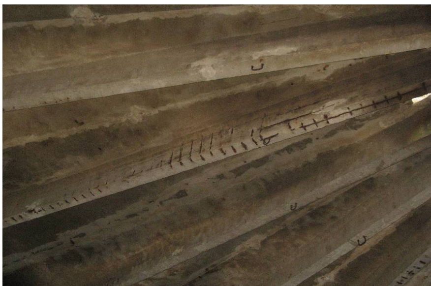
Fig. 5 – Element prefabricat tip „T” cu probleme de acoperire cu beton a armăturilor
